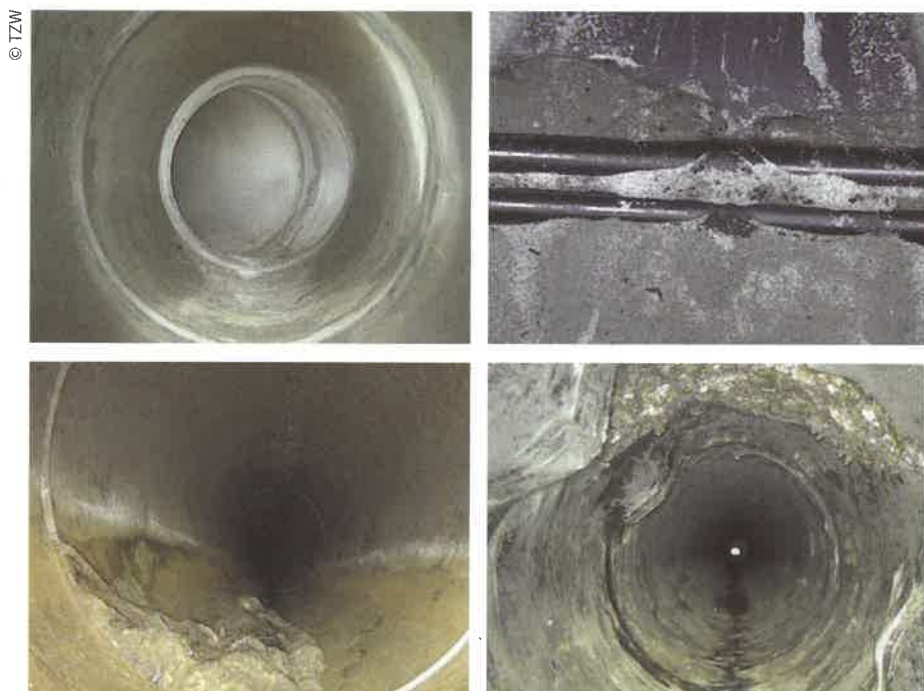
Bild 2: Beispiele unterschiedlicher Befunde: Qualitätskontrolle einer Neubauleitung (o.l.), Verunreinigungen in einer neuen PE-Leitung (o.r.), Wurzeleinwuchs (u.l.), Ablösung der Beschichtung (u.r.)
